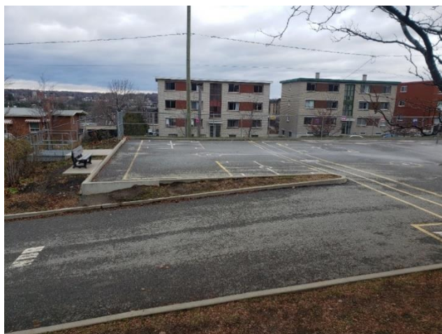
Cour avec bordure déchaussé 1
